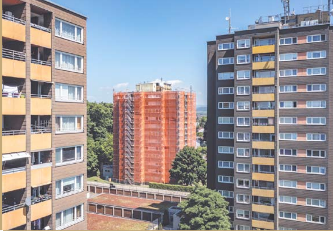
In Offenburg erhalten im Rahmen der energetischen Sanierung insgesamt drei Hochhäuser mit 152 Bestandswohnungen neue Kunststofffenster.
