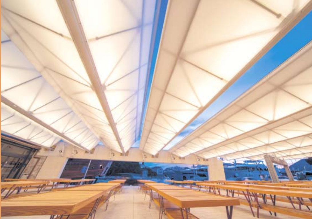
Die dreieckigen Prismen des Marktdaches aus PVC-beschichtetem Gewebe sind um die Längsachse drehbar und bieten damit einen effektiven Witterungsschutz. Foto: Belina d.o.o.
